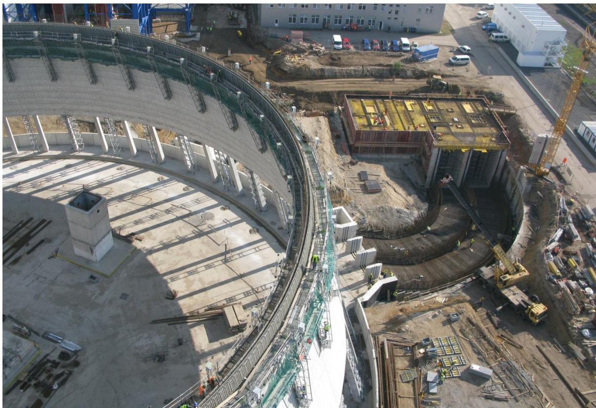
Obrázek 31 - Součástí dodávek je i výstavba čerpacích okruhů
