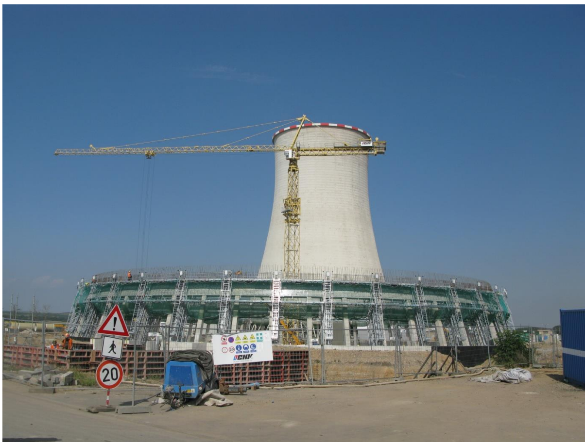
Obrázek 18 - Soubor zařízení po dokončení montáže
