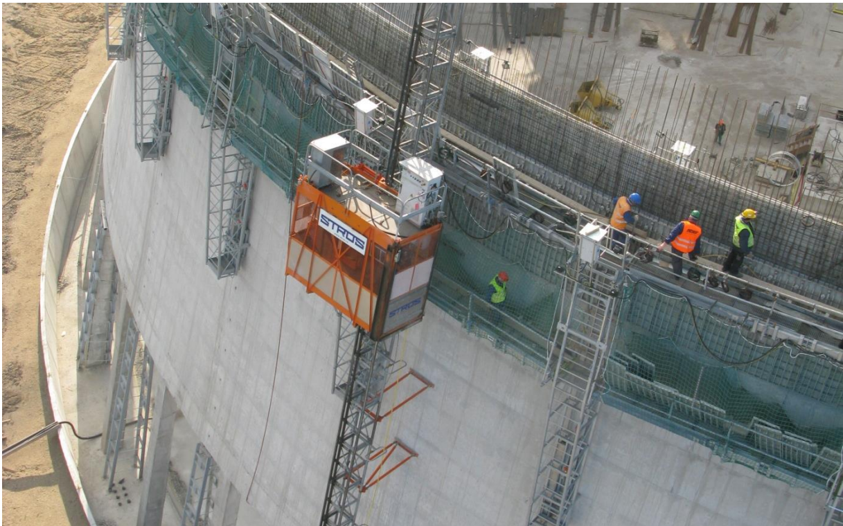
Рисунок 30 - Рабочая кабина на уровне комплекса оборудования
