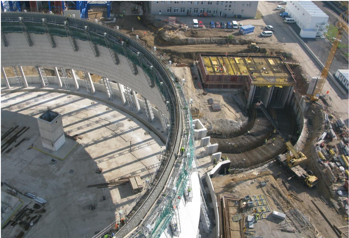
Рисунок 31 – В комплект поставки входит и строительство насосной станции
