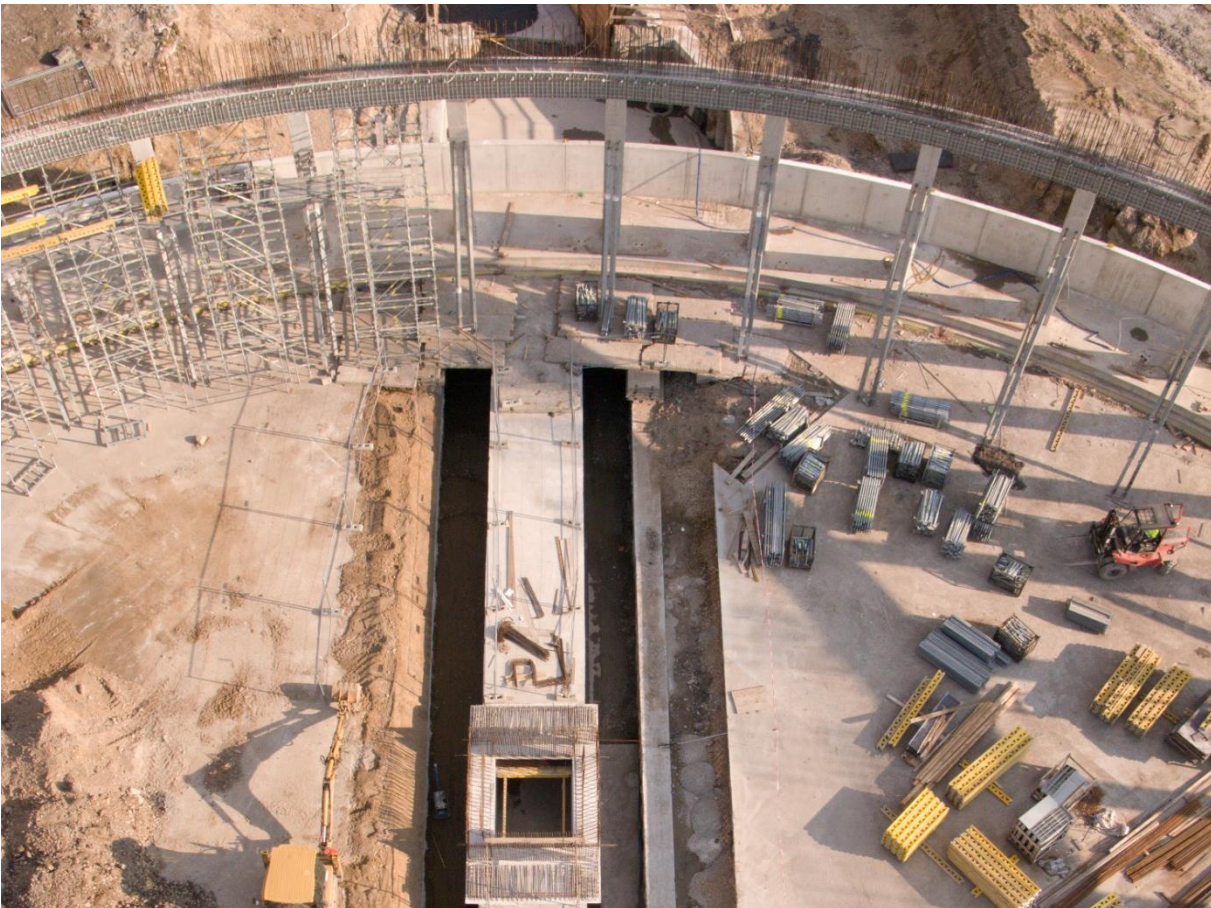
Рисунок 16 – Подводящий канал градирни
