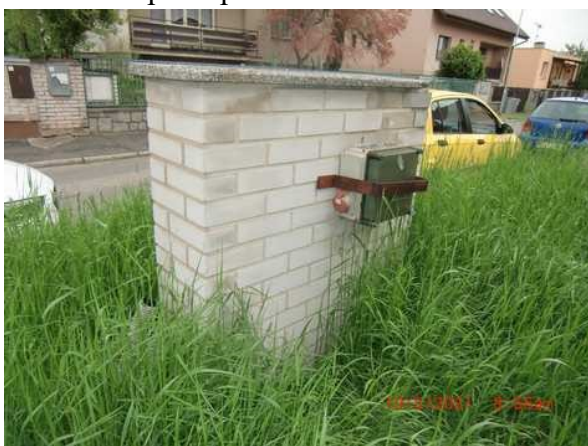
el. rozvodná skříň
