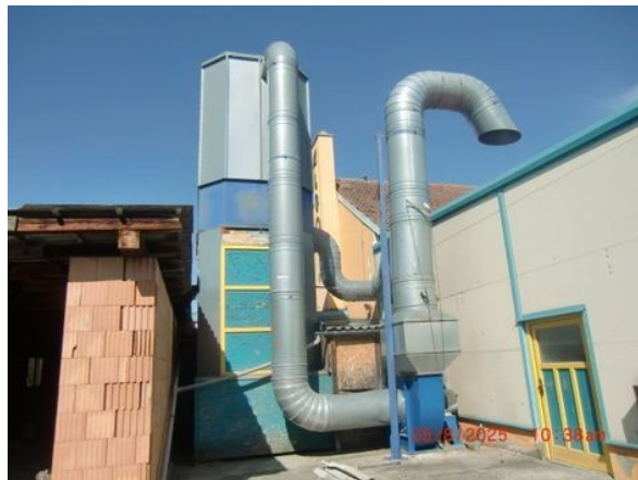
Technologie odsávání pilin
