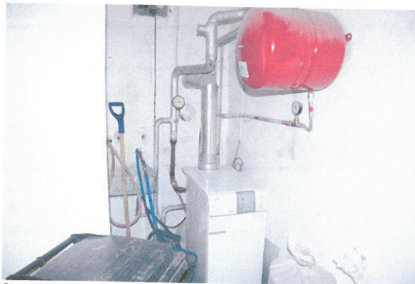
Sklad s plynovým kotlem
