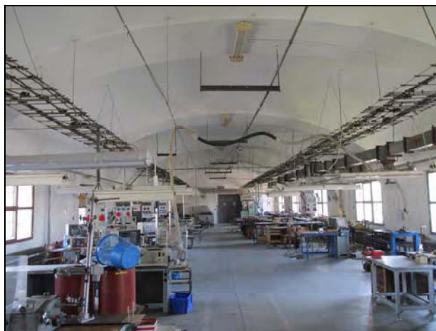
Foto č. 25 : Interiér výrobních ploch – výroba malých traf
