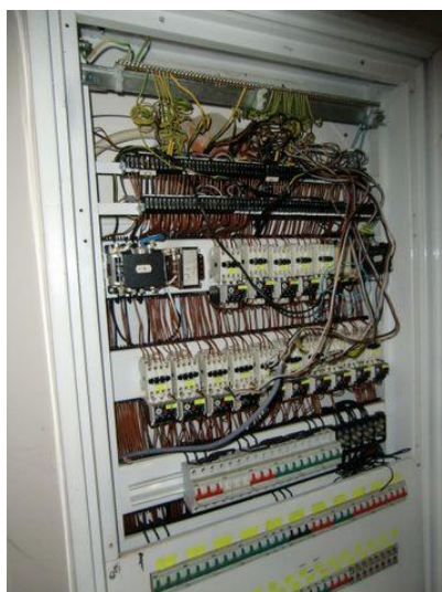
Rozebrané rozvodné skříňe
