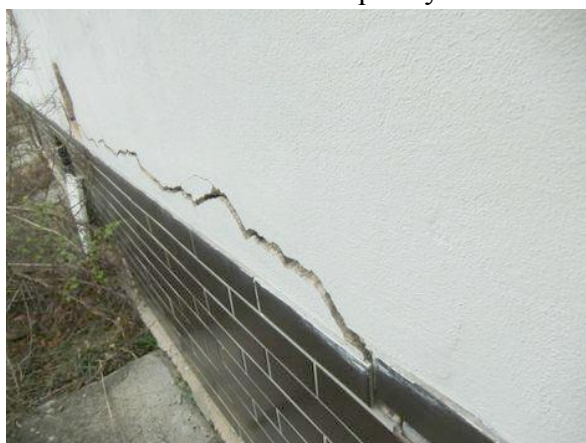
Prasklina obvodového zdiva
