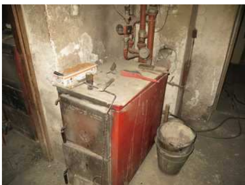
Kotel na TP
