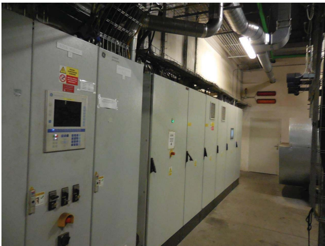
Obr. 4 Rozvaděče kogeneračních jednotek
