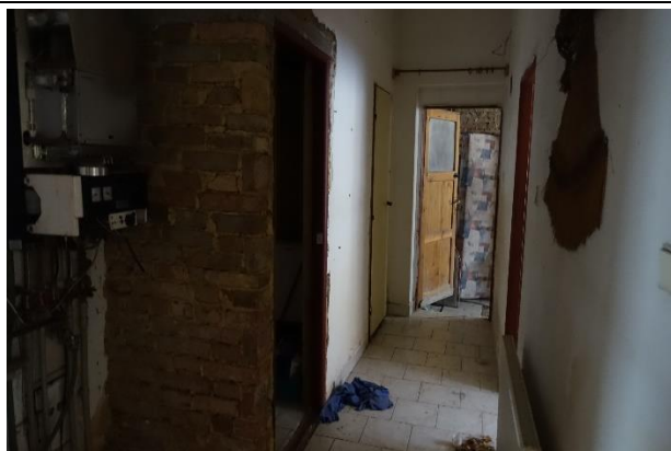
PŘEDSÍŇ s kotlem UT
