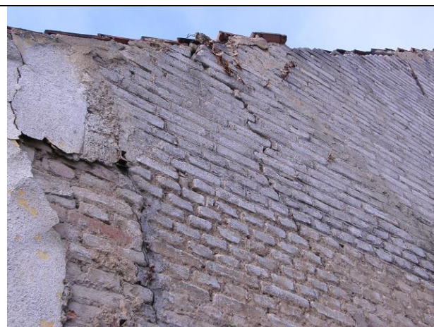
DETAIL ŠTÍTU S TRHLINAMI VE ZDIVU
