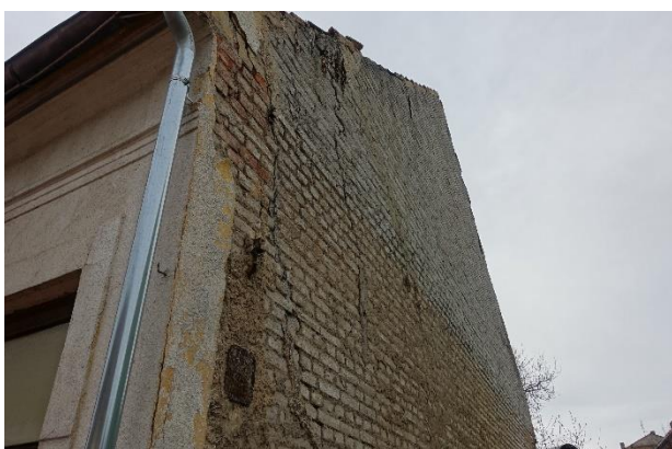
POHLED BOČNÍ s trhlinami
