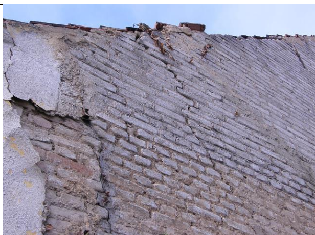
DETAIL ŠTÍTU S TRHLINAMI VE ZDIVU
