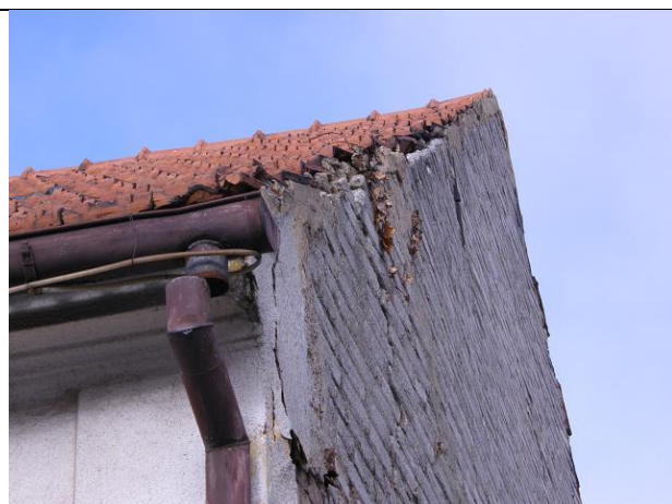
DETAIL ŠTÍTU S TRHLINAMI VE ZDIVU
