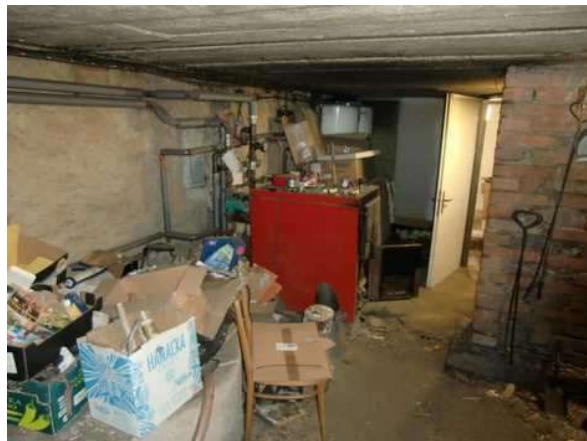
interiér 1.PP domu č.p. 117 (kotelna)
