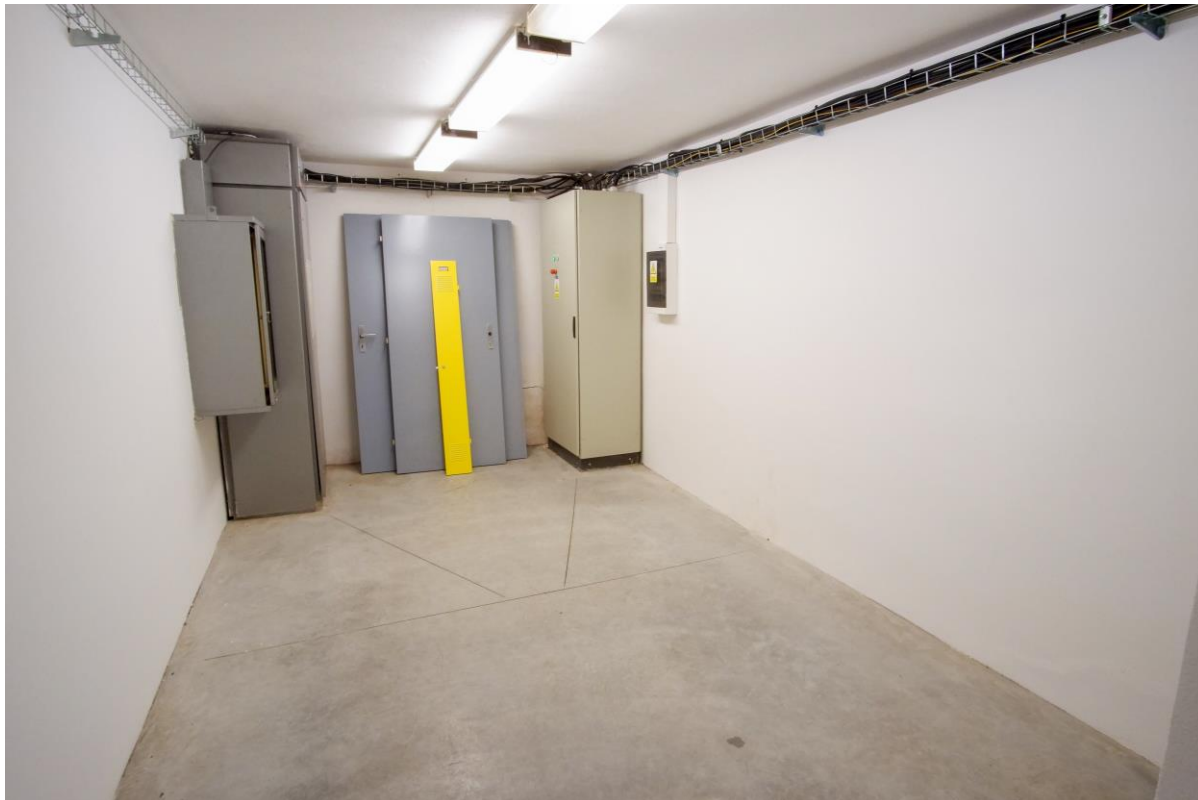
Obr. č. 6 – Výrobní a skladová hala č. 113, rozvodna
