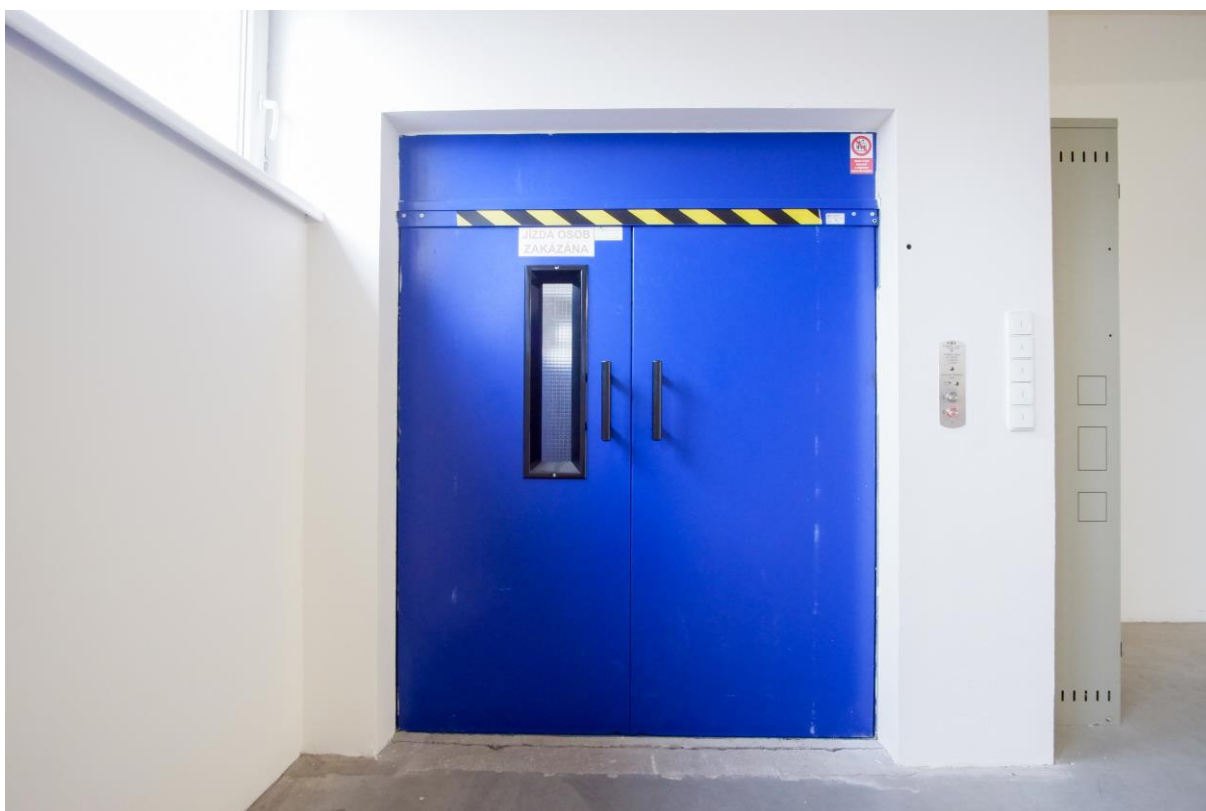
Obr. č. 3 – Výrobní a skladová hala č. 113, nákladní výtah
