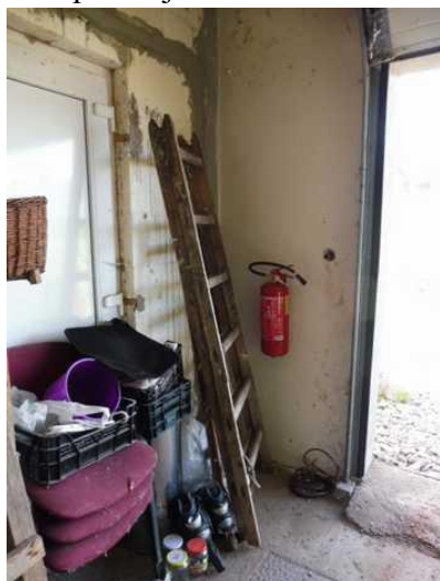
hasící přístroj - garáž
