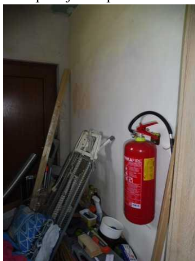
hasící přístroj - technická místnost
