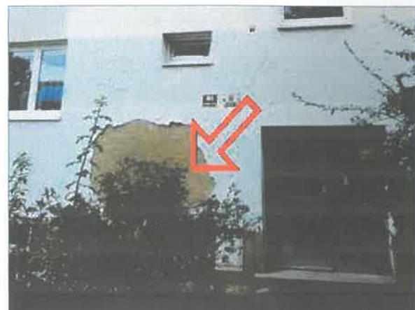
Příklad poškozených omítek
