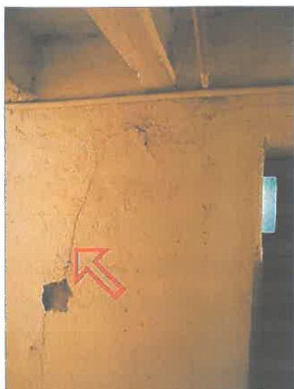
Příklad trhlin v 1.PP
