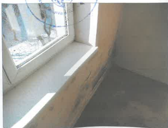
Příklad narušené omítky s tvorbou plísní
