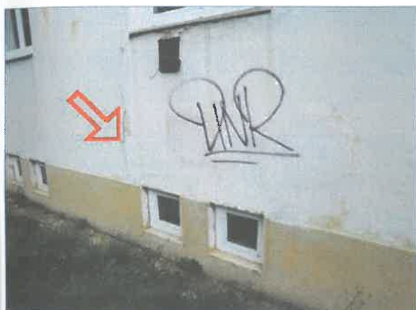
Příklad trhlin na fasádě
