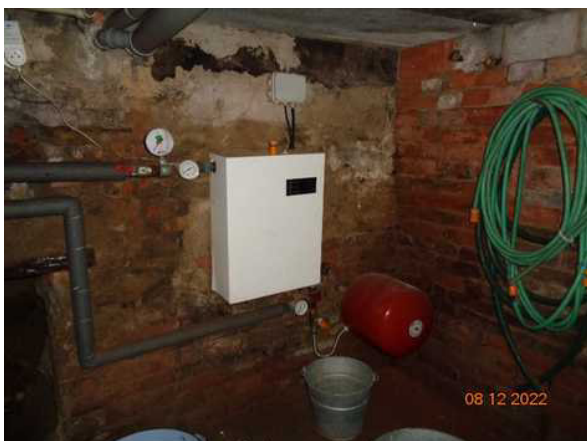
El. kotel ve sklepě
