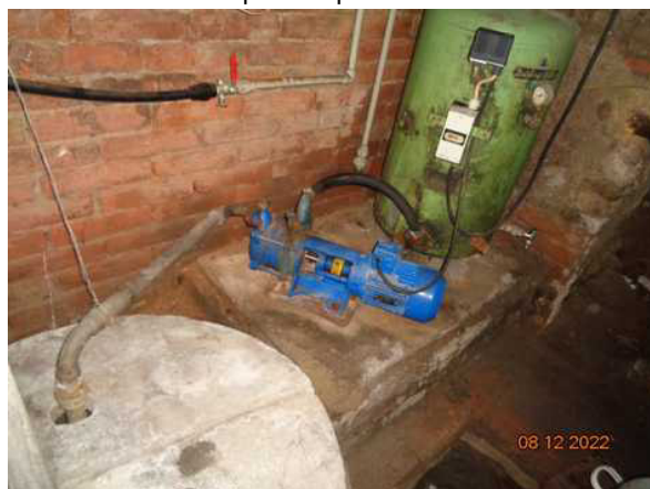
Studna s čerpadlem a darlingem ve sklepě
