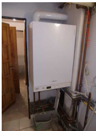
plynový kotel v tech.místnosti
