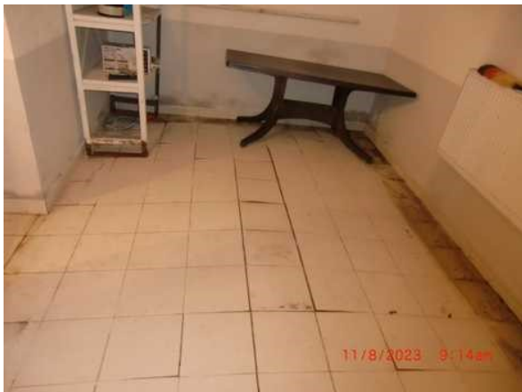
havárií poničená podlaha v sušárně
