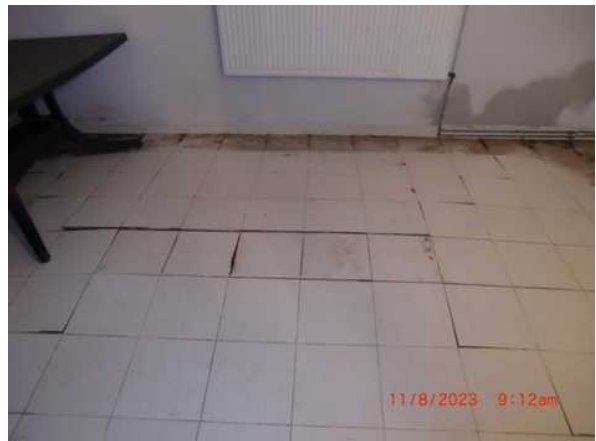
havárií poničená podlaha v sušárně
