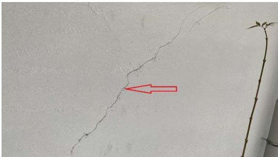
Na části obvodového zdiva původní budovy jsou patrné praskliny
