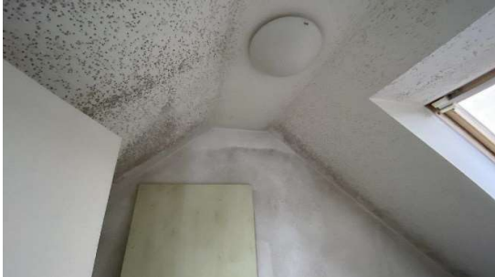
V některých místech budovy se tvoří rozsáhlá plíseň
