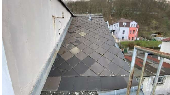
Poničené střešní šablony
